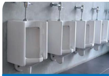
尿石による詰まり
