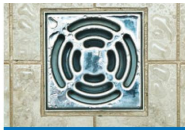
配管の詰まり
